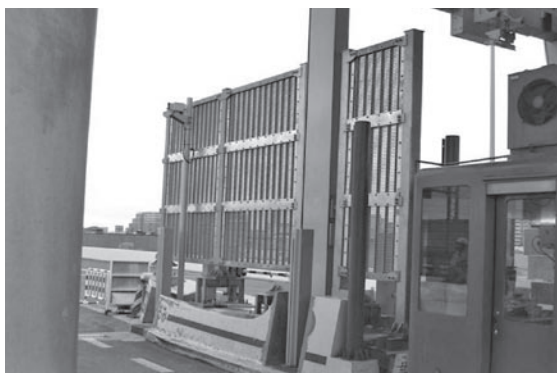
写真1 スリット型電波吸収壁 (ETCレーン間用)
